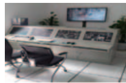
辦公區域電視監控機房
